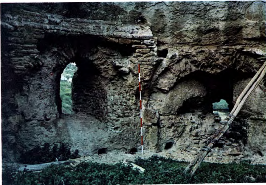
Saeteras en la tercera planta de la Torre del Homenaje, con las trompas de la bóveda.
