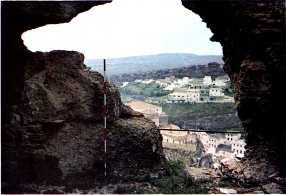
Portillo muy erosionado en la argamasa de Tapial de la tercera planta.
