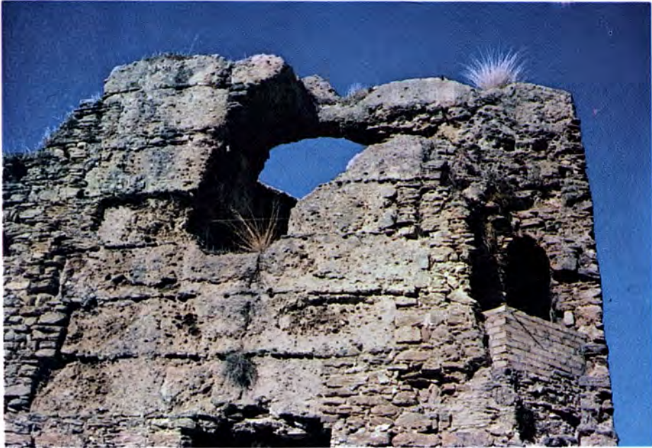
Accesos, muy deteriorados, entre las plantas de la Torre del Homenaje.
